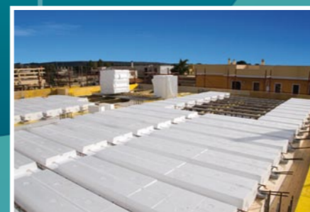
L'armatura sporgente dai travetti, annegata nella trave, è dimensionata per assorbire gli sforzi pari al taglio e alle azioni sismiche
